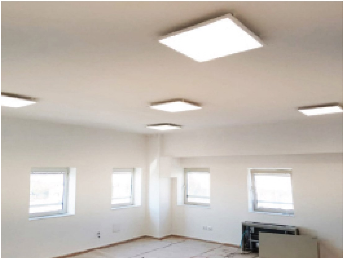
Figura 23: Realizzazione di un impianto di illuminazione a soffitto per l'azienda di domotica, impianti elettrici e di energie rinnovabili VET S.r.l. con il Nastro elettrico NM2BT15
