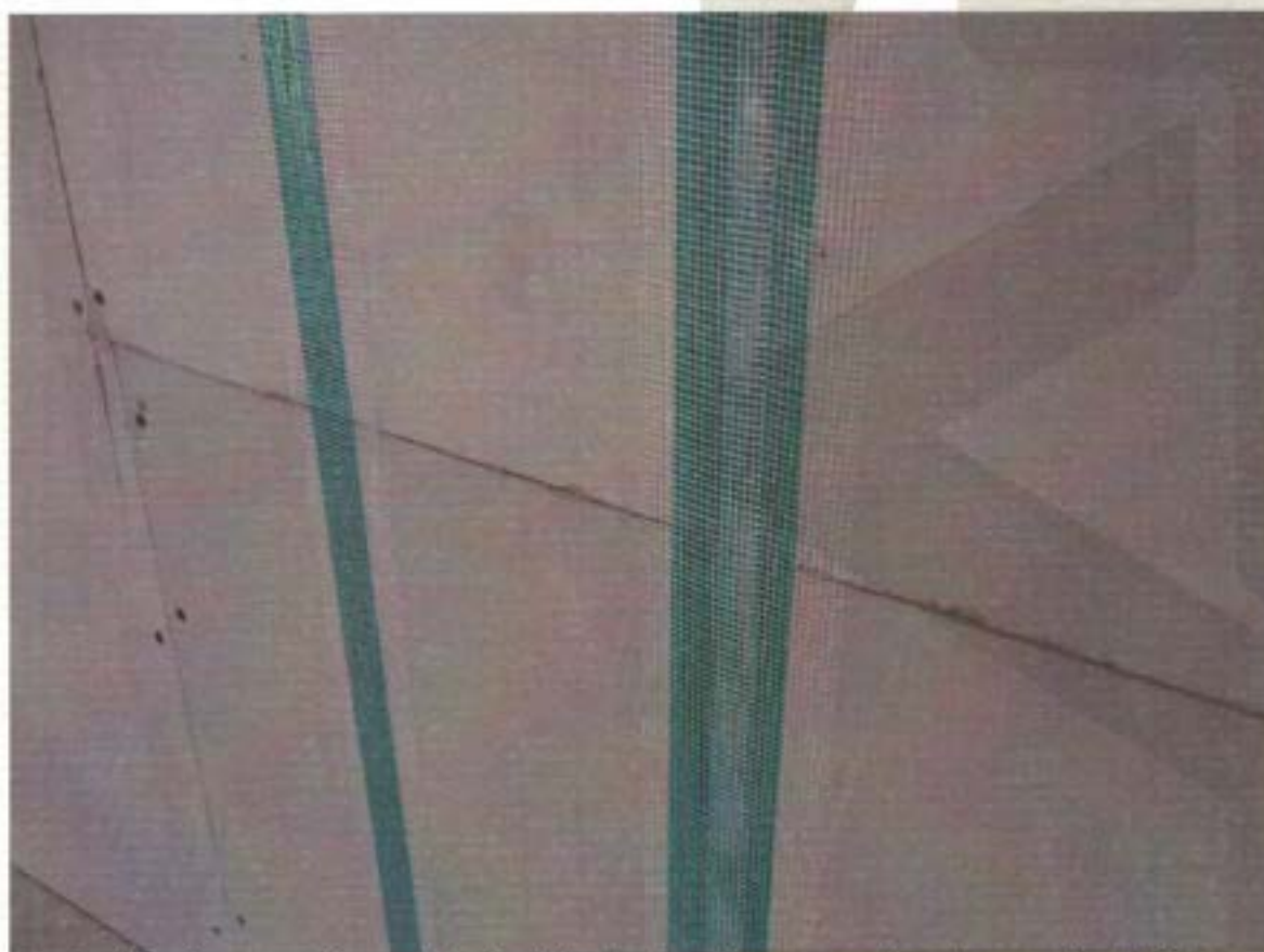
Foto 2: Applicazione nastri conduttori sullo strato esterno – applicazione nastro di rinforzo per cartongesso
