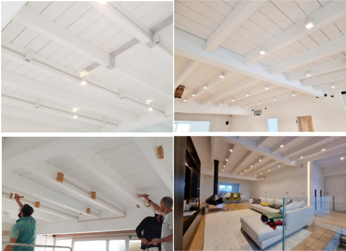
Figura 22: Realizzazione di un impianto di illuminazione a soffitto per un appartamento privato con il nastro elettrico NM4BT05
